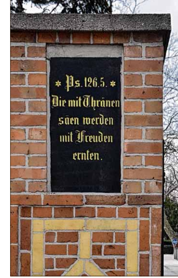
Die Inschrift der Psalmenplatten am Eingang des Friedhofs sind wieder leserlich.
